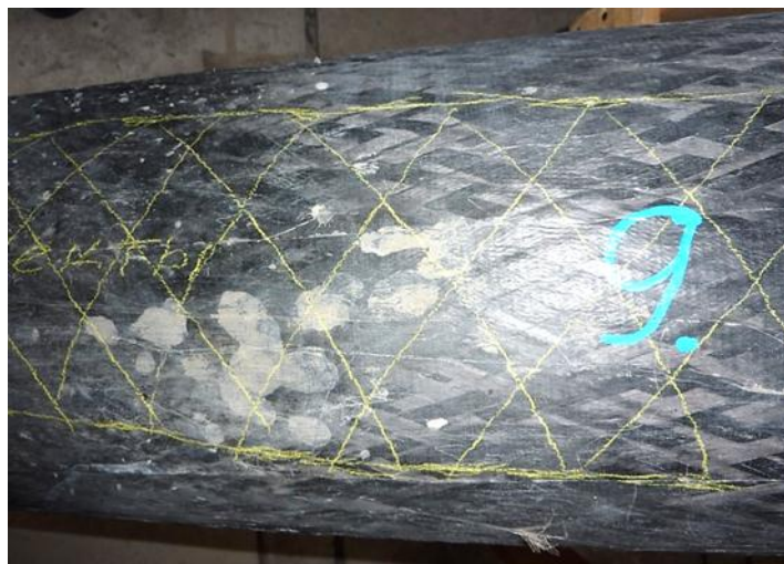
Рис. 6. Зона арочного элемента, не заполненная бетоном (заштрихована)
