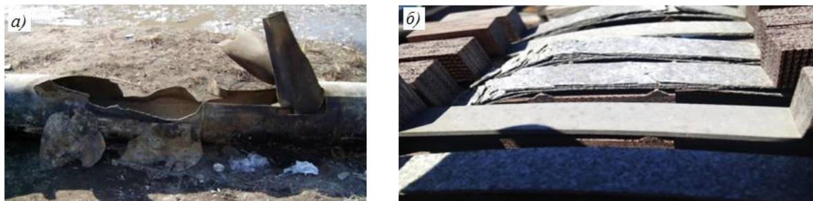
Рис. 2. Хрупкое разрушение стального трубопровода (а) и расслаивающая коррозия алюминиевого сплава (б) [6]
