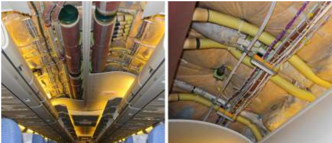
Рис. 1. Трубопроводы системы кондиционирования воздуха самолета Boeing 737
