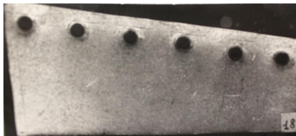
Рис. 14. Коррозия нижней обшивки из сплава Д16-АВТ закрылка самолета, созданного в ОКБ А.С. Яковлева
