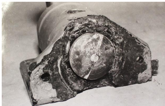
Рис. 9. Коррозия литого узла из-под пола фюзеляжа из сплава МЛ5-Т4 тяжелого военно-транспортного самолета, разработанного в ОКБ С.В. Ильюшина
