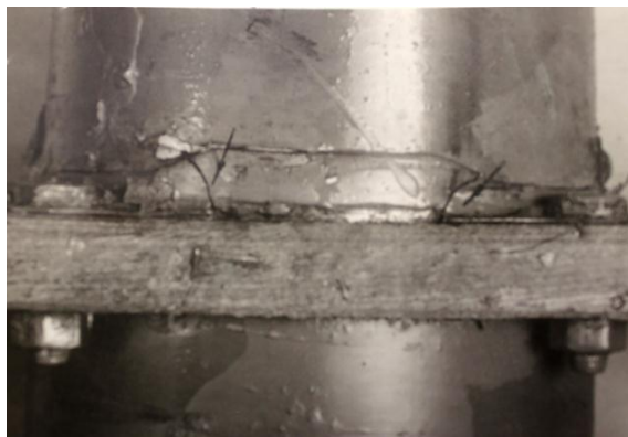
Рис. 18. Трещина припаянного хомута, соединенного с лонжероном, в лопастях смешанной конструкции несущего винта вертолета, разработанного в ОКБ М.Л. Миля
