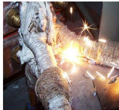
Рис. 6. Воспламенение термоиндикатора в результате превышения критической температуры при проведении сварочных работ
